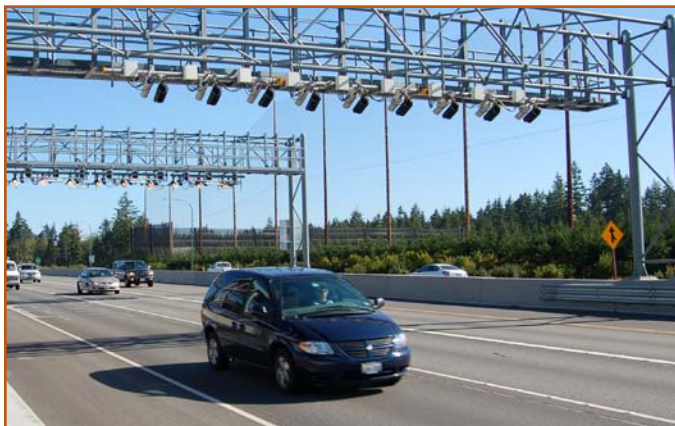
Hệ Thống Thu Phí Cầu Đường Điện Tử Mẫu
